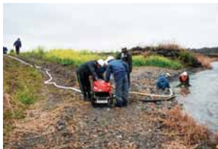
小丸川からの給水
