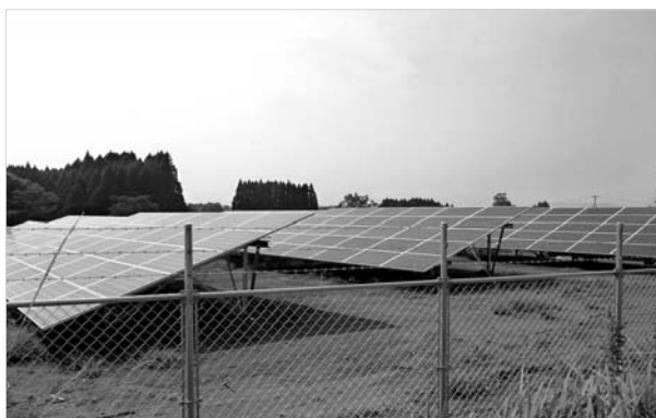
太陽光発電施設
