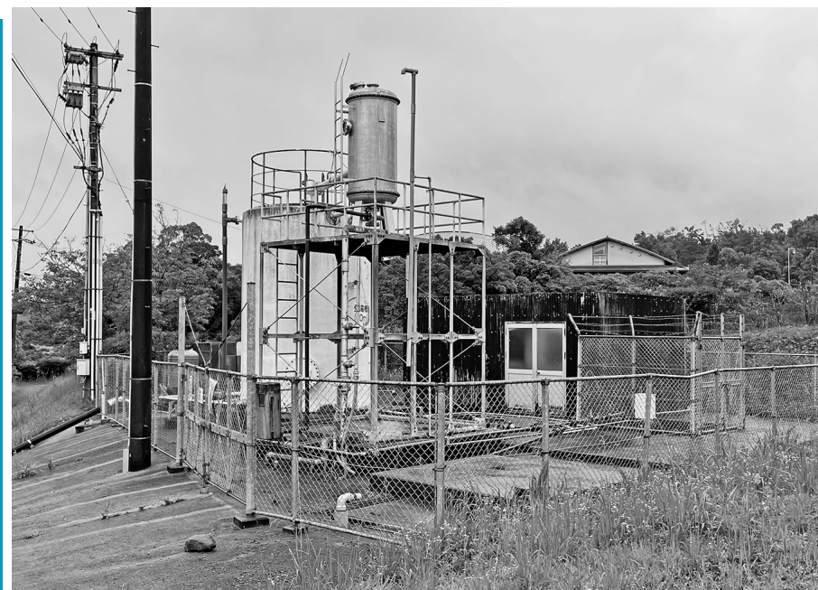
町の管理する温泉源泉施設
