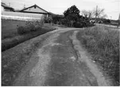
老朽化している町道
