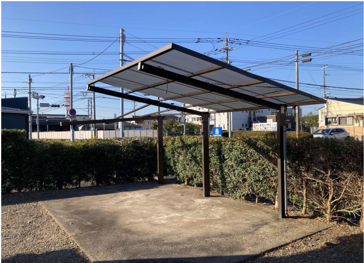
物件写真（カーポート-破損）
