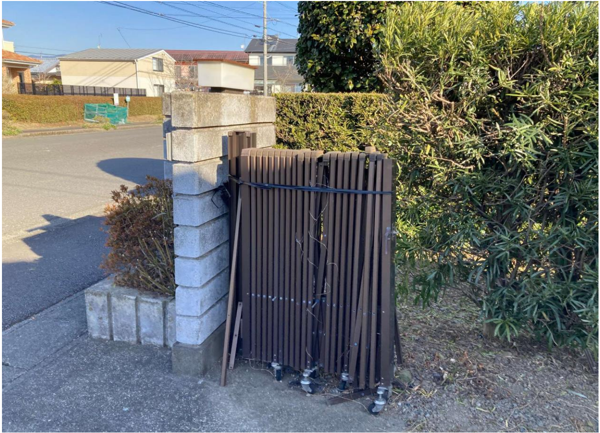
物件写真（門扉-破損）
